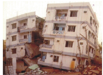
गलत ढंग से बनाई गई कमजोर अथवा लचीली मंजिल भूकम्पों के दौरान घटिया कार्य निष्पादन का परिचय देती है । भुज में कई ऐसे भवन जिनकी निचली मंजिल वाहन खड़े करने के लिए खुली रखी गई थी भूकम्प में ढह गए थे । ऊपर चित्र में आंशिक रूप से रखी गई निचली मंजिल के कारण भवन में ऊपर की तरफ दरार दिखाई दे रही है ।
